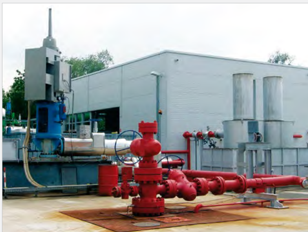
Das Geothermiekraftwerk in Landau – im Vordergrund die Förder- und die Injektionsbohrung. Bild: Marcus Brian, Enerchange
