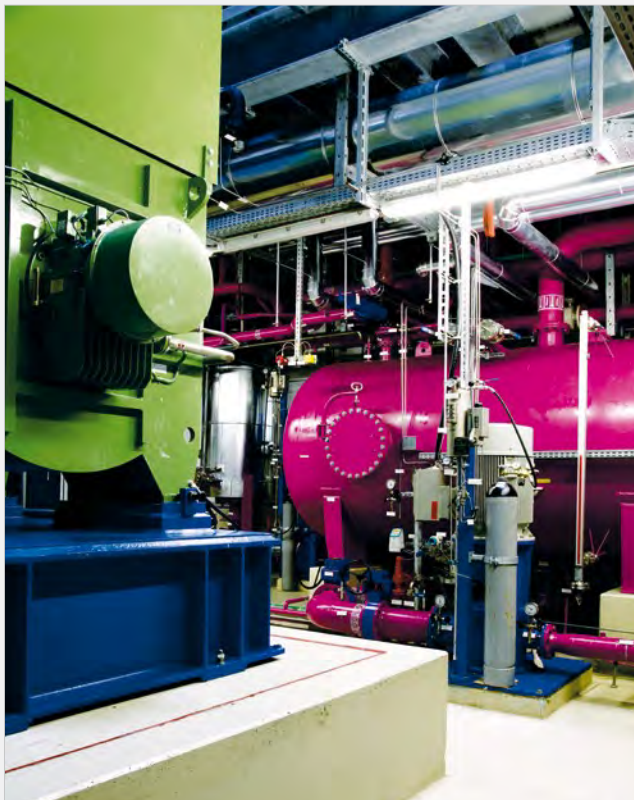
Im Inneren des Kraftwerks in Unterhaching. Foto: Geothermie Unterhaching GmbH & Co. KG
